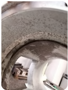
Corrosie op gecoate elementen
